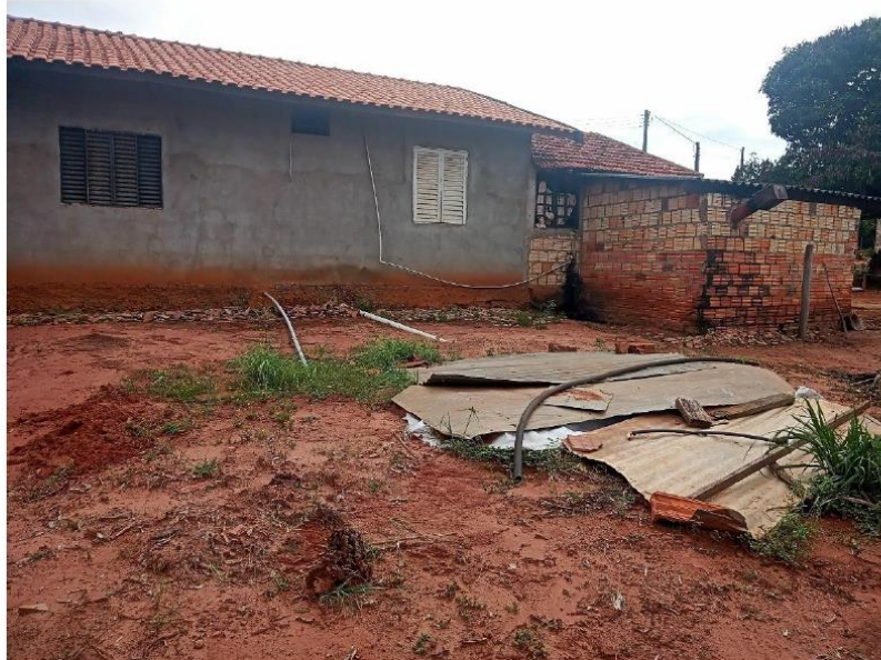
1. Fossa aberta revestida com eternite
