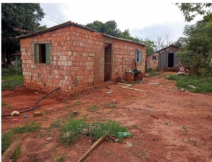
8. Lançamento de esgoto na superfície do solo
